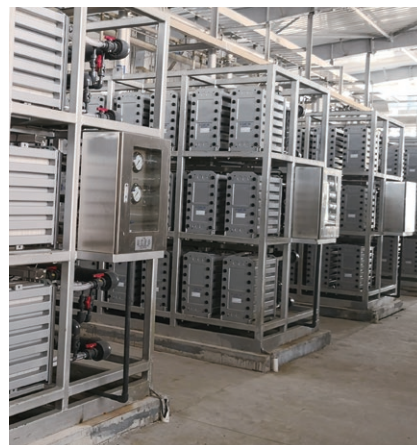
中海油惠州炼化二期化水站
